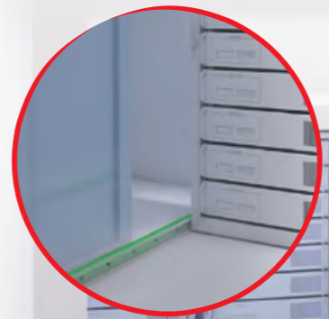
> Estrazione moduli server Server rack slide out
